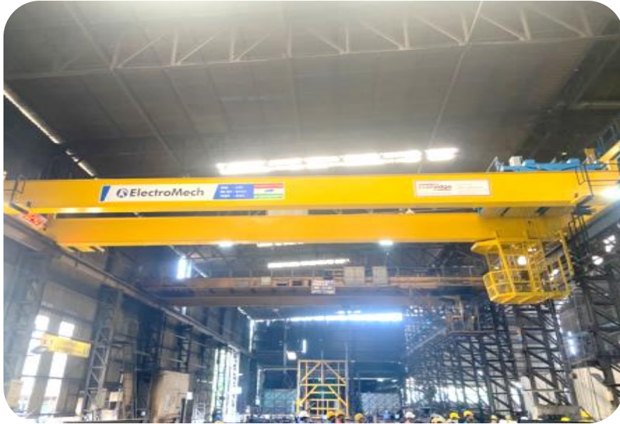
15 & 25 MT EOT crane
